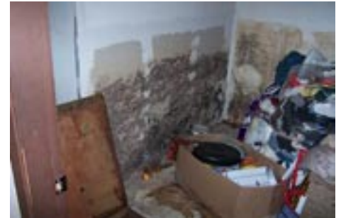
Moldy "standard" drywall.
